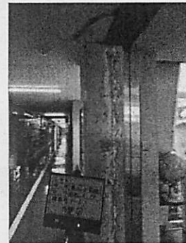
小金井第二小学校 校舎(①-1棟) D評価 防水層の剥がれ等があり、雨漏りが 内部にも影響を及ぼしている。
