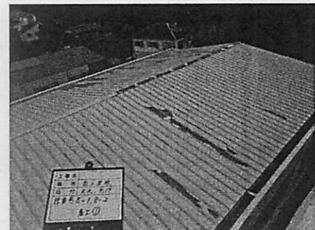
南小学校 体育館、校舎(⑧-1、⑧-2棟) C評価 金属屋根の体育館。 屋根葺材に損傷がある。
