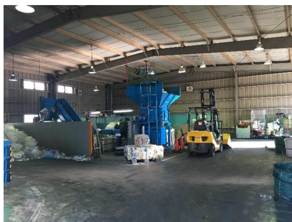
受入ヤード、破袋機、手選別コンベヤ、 ペットボトル減容機
