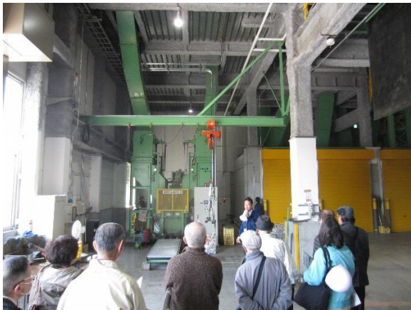
金属圧縮機・カレットストックヤード
