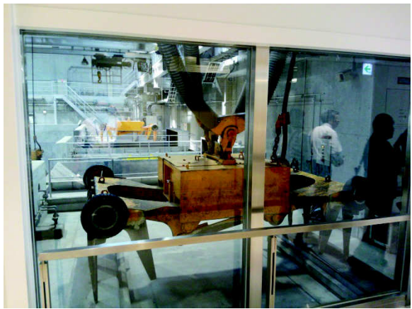
可燃ごみを焼却炉の投入するクレーン
