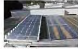
雨水ろ過集水樋 (きれいな雨水をあつめる)
