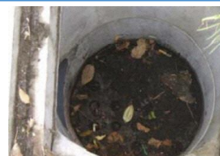
浸透ますの底部が土砂で覆われた状態 ※
