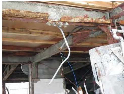
建物に残存した吹付け材
