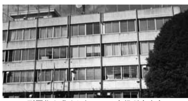
耐震化を求められている市役所本庁舎
