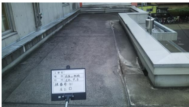
前原小学校 校舎(③棟) C評価 対象棟の中では最も新しい校舎だが、 笠木の損傷や防水層の剥がれが見られる。
