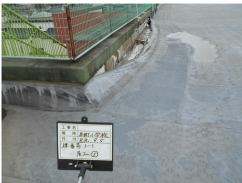
本町小学校 校舎(①-1棟) D評価 シートが破断してめくれており、 12条点検で指摘されている。
