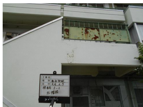
南中学校 校舎(1-1棟) C評価 外階段の金属部に錆がある。脆くなると、崩落して転落事故や落下事故に繋がる恐れがある。
