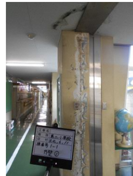
小金井第二小学校 校舎(①-1棟) D評価 防水層の剥がれ等があり、雨漏りが 内部にも影響を及ぼしている。
