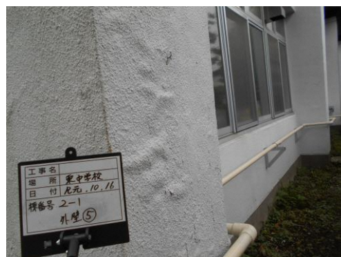
東中学校 校舎(2-1棟) D評価 外壁に浮きが見られる。また、この写真には写っていないが、亀裂も複数ある。
