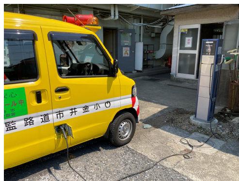
電気自動車充電設備
