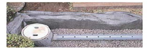
浸透管 (排水管)
