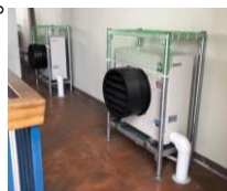
屋内運動場エアコン
